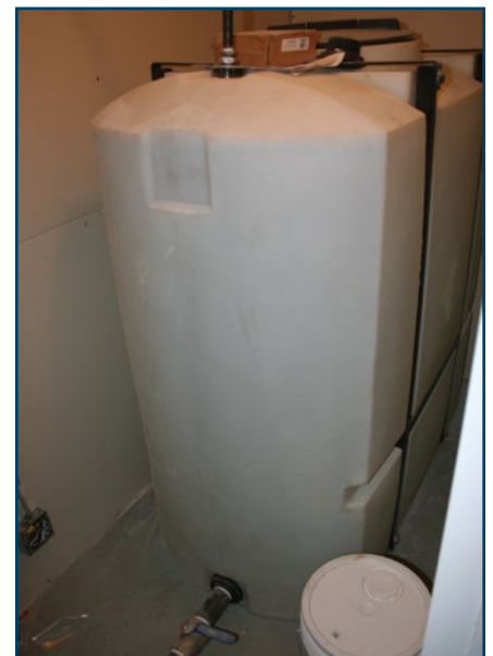
Figure 2 : Réservoir d'eau dans une habitation Photo : Ron Wickman
