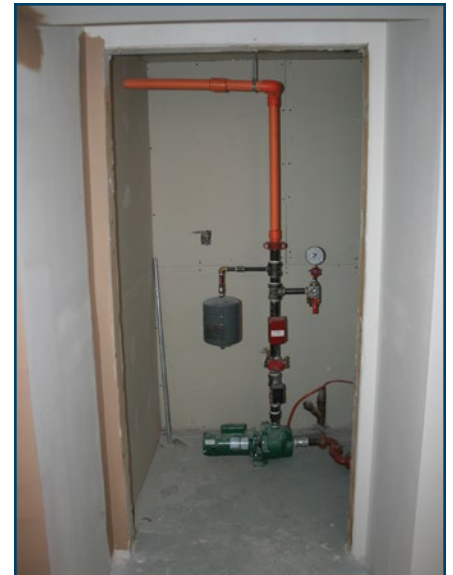
Figure 1 : Approvisionnement en eau des gicleurs Photo : Ron Wickman
